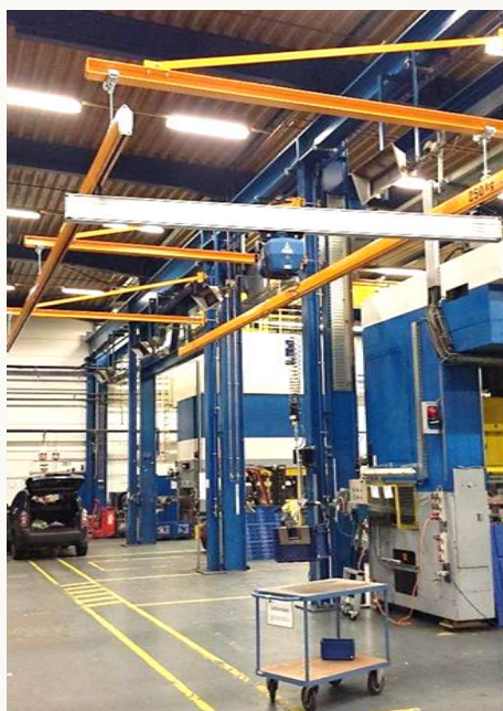
Das Stahl -Aluminiumschienenportal ist an Hallenträger montiert ; belegt keine Betriebsflächen.
