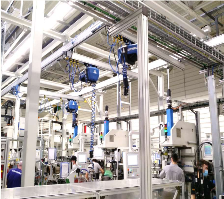
Konzeption, Layout und Montage des freistehenden Aluminium Schienenportal mit 4 Brücken; Medienversorgung: IGUS-Schleppkette und innenliegende Stromversorgung der Kranbahnen.
