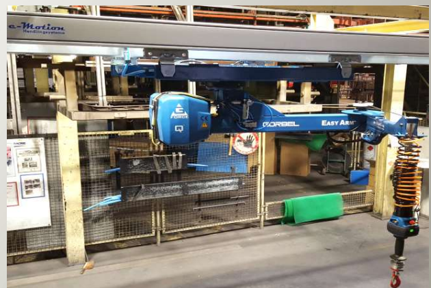
Abhängen des Aluminiumschienenportal mit hängendem Knickarm-Manipulator ; zur Be- und Entladung von Truck-Baugruppen.
